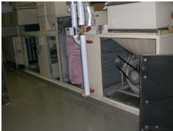
Foto 6 Elementnr. 577140 1 st. Luchtbehandelingskast.
