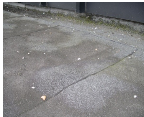
Foto 1 Gebrek: blazen/plooiën, verspreid over dak, omvang 10%
